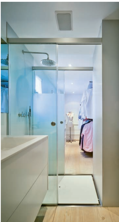
Instalación con Soporte Flotante
